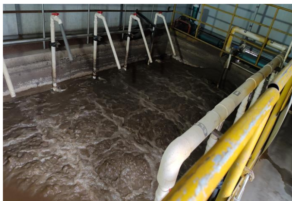
照片 8-2-12 生活污水处理内部
