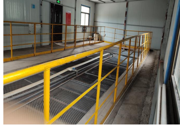
照片 8-2-13 生活污水处理内部
